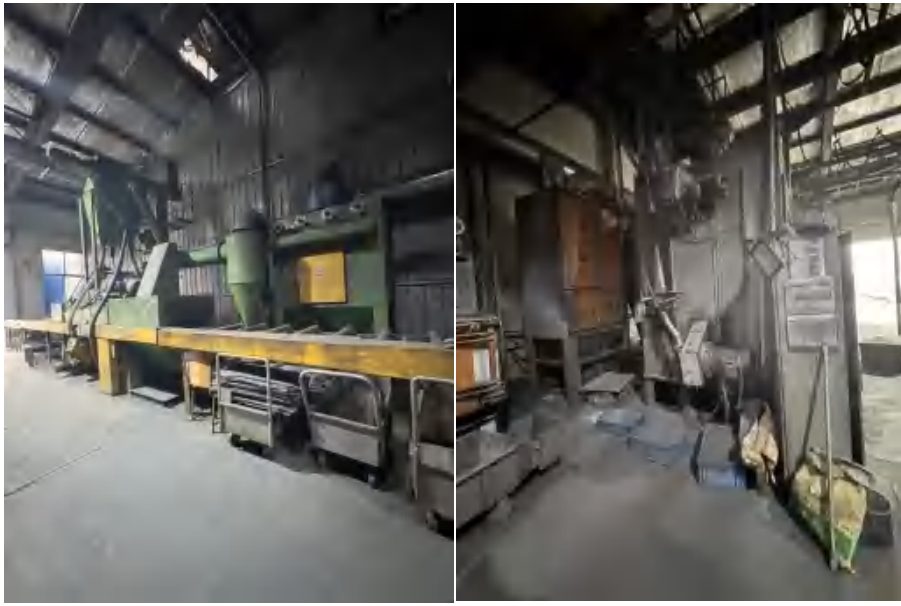
抛丸机脉冲滤筒除尘装置
