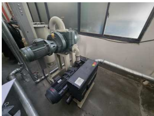
浸渍炉真空泵收集
