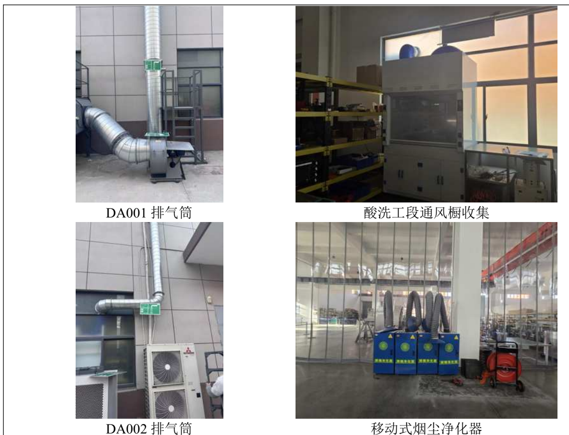
图 3-1 废气收集处理设施现场照片
